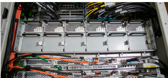
그림 3 - AWS Outposts AC-to-DC 전원 공급 장치 및 버스 바 전원 분배
